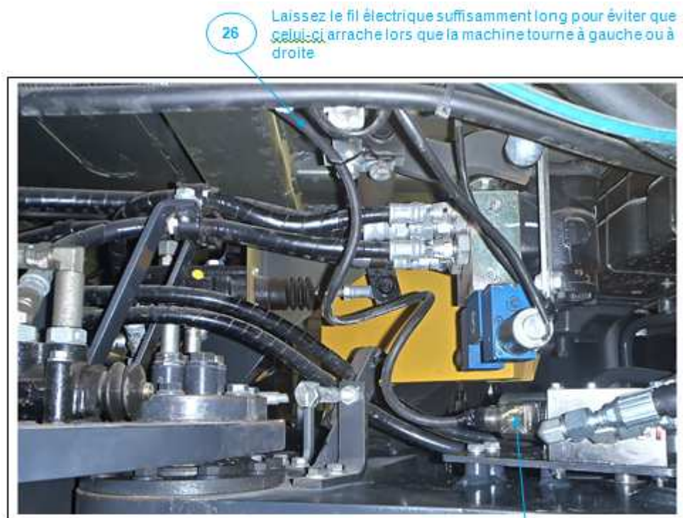
Fig. 13 (Vue au-dessous de la cabine à droite)
